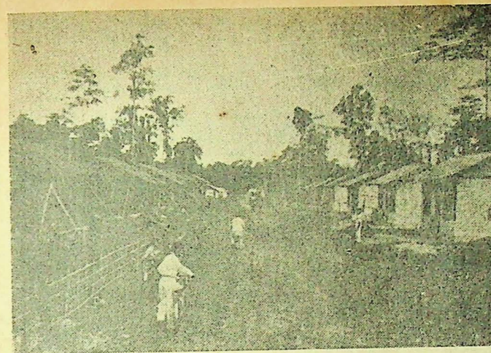
Ceram membangun: kota Masohi yang kini sedang dibangun untuk mendjadi ibukota dari Maluku Tengah. Tampak rumah2 dan djalan2 yang sedang dibangun..... (Gambar: (M.M.)
